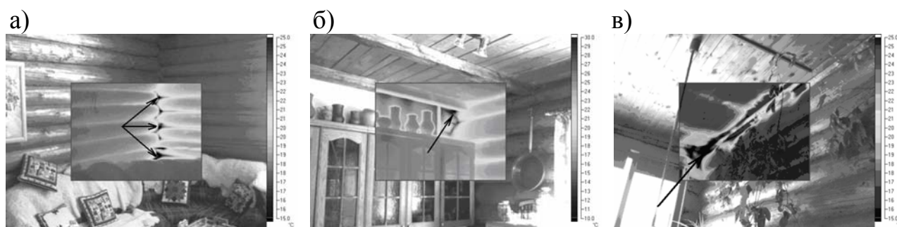
Рис. 2. Мостики холода на термограммах внутренних поверхностей дома:
